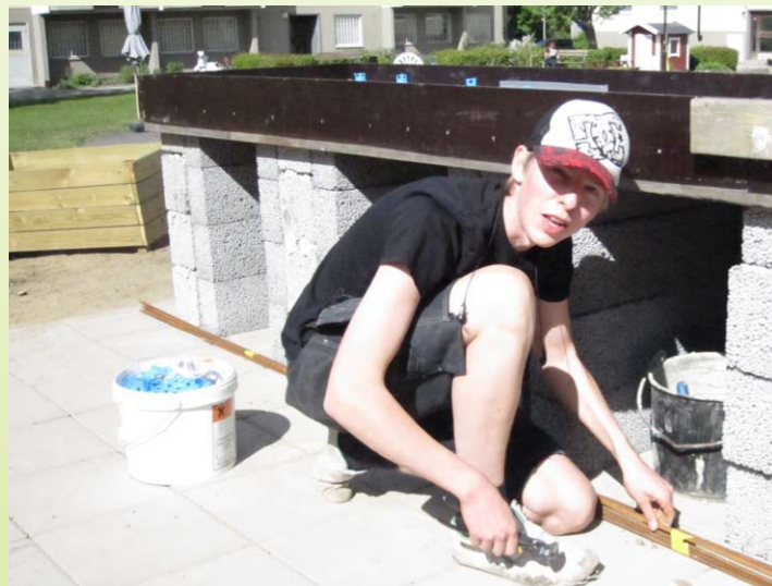
En av de yngre medhjälparna, Robbin var tidigt ute och armerade bänkskivan, som skulle gjutas på kvällen av den mångfasetterade samlingen av "autodidakter".
