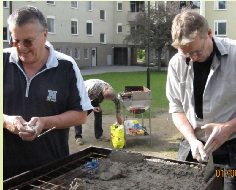
Nu har det lagts i en del betong i formen och man kan se att Calle och Raffe nog har förträngt behoven av att få leka med "geggamoja" under en lång period, Calle är så ivrig att han inte vet vad han ska börja. Bakgrundens gestalt vid den lilla grillen är vår egen grillmästare Sture, som vet hur man ger korven den rätta värmen.
